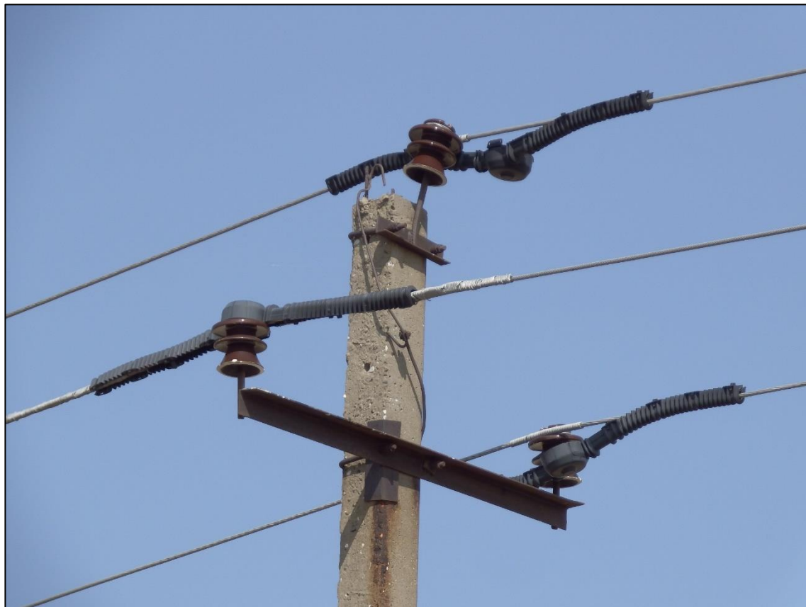
Фото 1. Пример неэффективного ПЗУ (производитель ООО «Авис», г. Тольятти), защитный кожух которого, переворачивается, не выдерживая ветровой нагрузки, что создаёт опасность электропоражения птиц. Волгоградская обл., Палласовский р-н (Приэльтонье).
