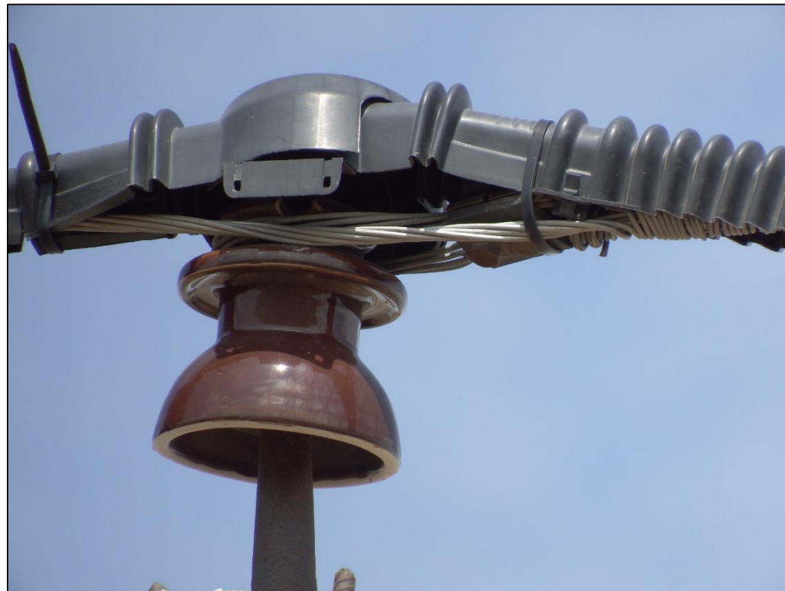
Фото 2. Пример неправильного монтажа ПЗУ (конструкционная несовместимость формы защитного кожуха и нестандартного узла крепления провода к изолятору).
